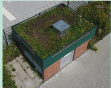
Smartes Retentionsgründach mit gesteuerter Drossel © J. Tiedemann (HAMBURG WASSER)
